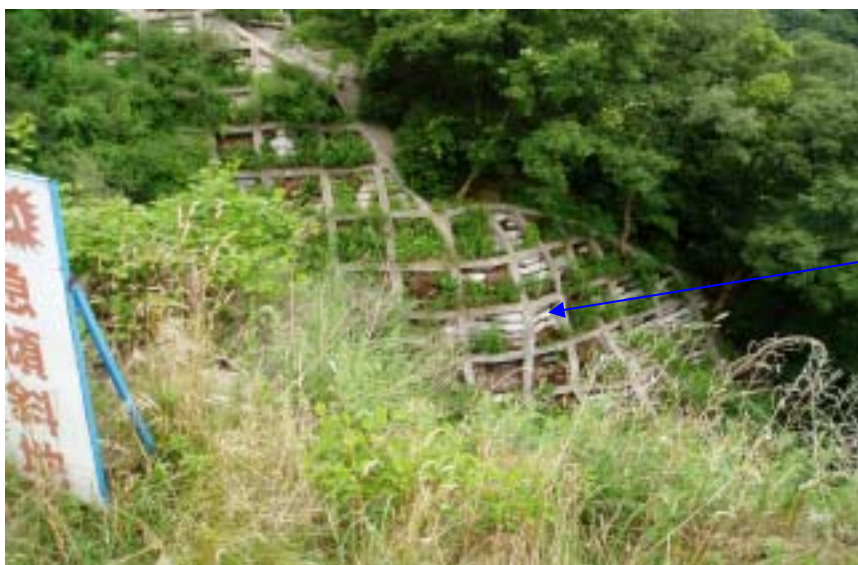
他工法 失敗事例
