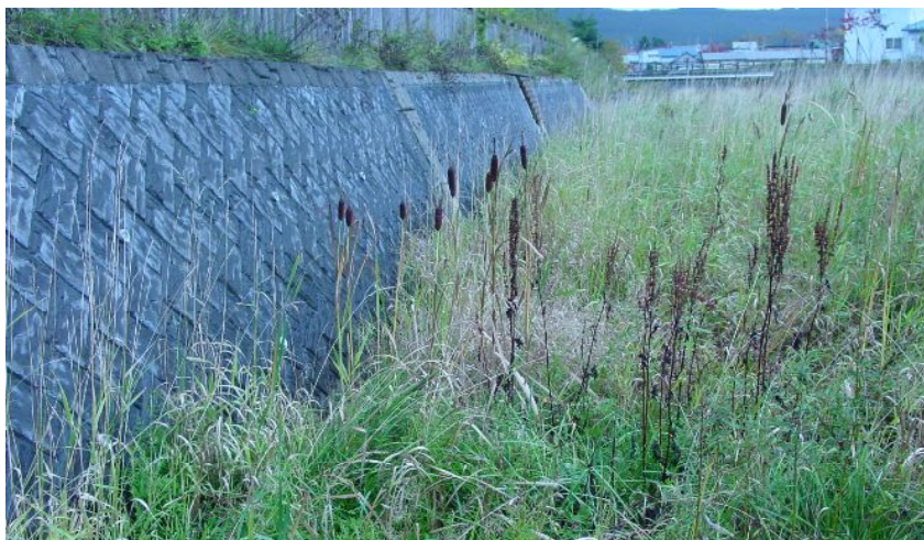
植生状況(ガマの侵入)
