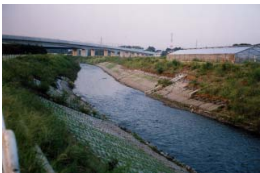
冠水後の状況
