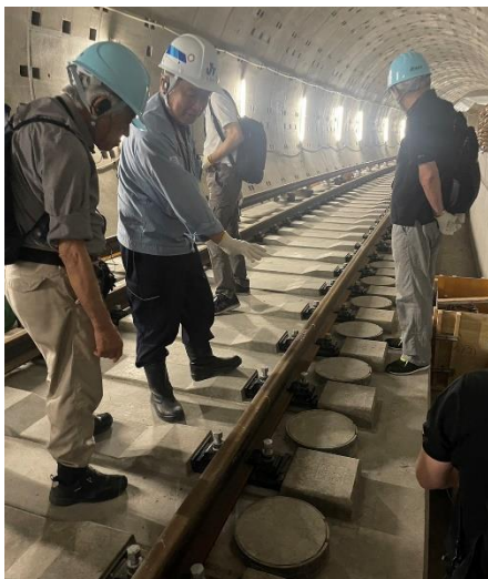
レール横の円筒形なのが「コイルばね防振装置」約3cm スラブ軌道を浮かして弾性支持しています
