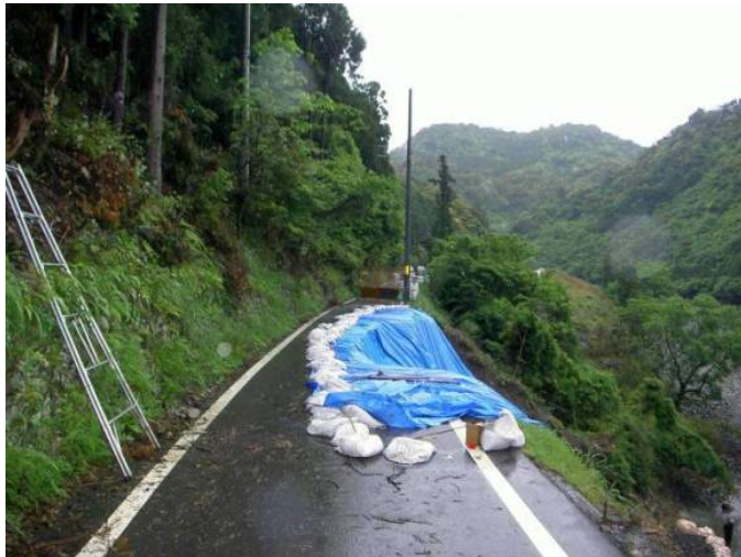
平成18年5月 豪雨災害による土砂崩壊 (古座川町小川地区)
