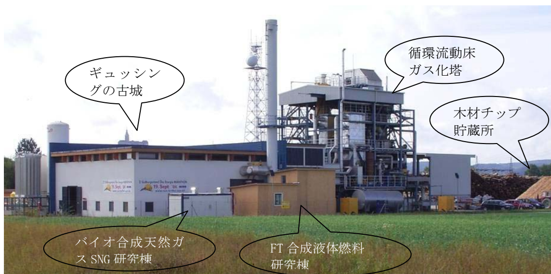
図 25 ギュッシング市 8MW 循環流動床ガス化施設等
