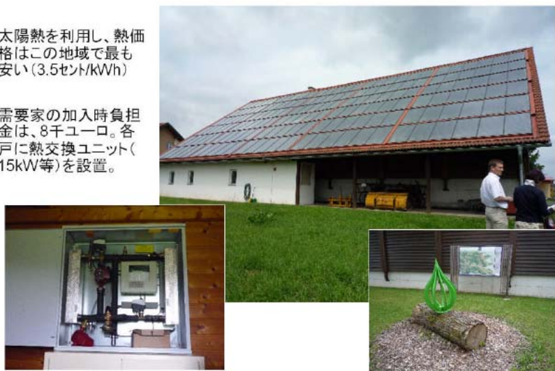
図 28 太陽温水器を屋根に装備したチップ倉庫とボイラー室、左の装置は各加入家屋に設置される熱交換器と管理用通信装置である。
