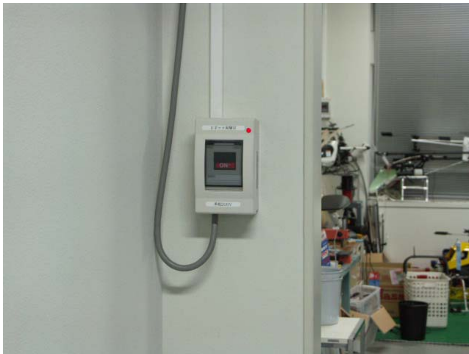
図 38 ロボット室電源
