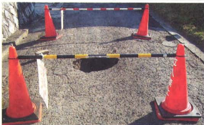
アスファルトはひび割れ、道路の中央が大きく陥没している(昨年12月8日)＝住吉台地番整理協議会提供
