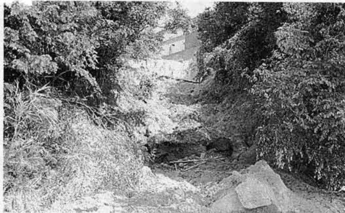
土砂崩れのあった現場(大津市和邇北浜)
